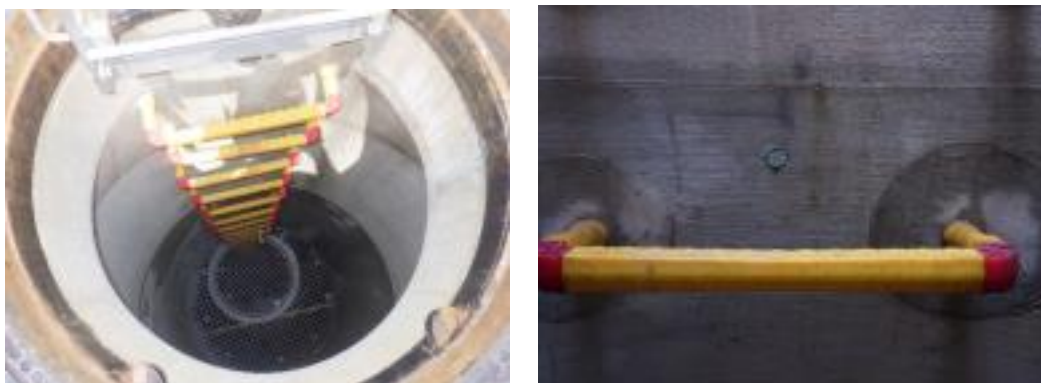
写真 3 マンホール内面状況（その1） 写真 4 マンホール内面状況（その2）
