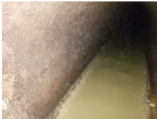
写真 4 管の内面状況 (その 2)
