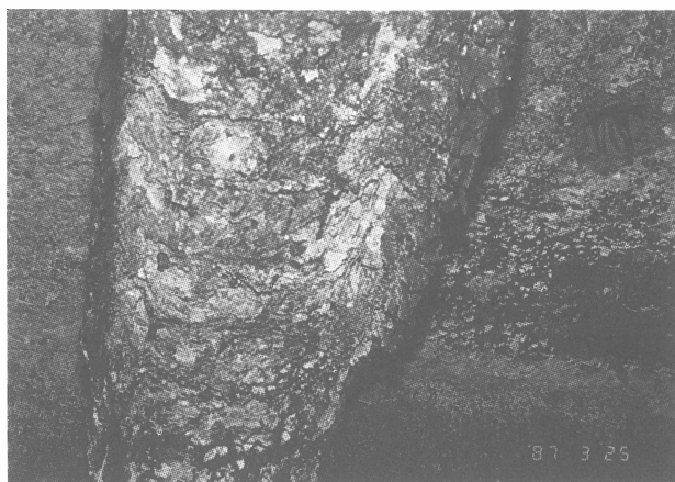
写真1 セッコウ化した汚泥受槽の梁 (硫化水素濃度約80ppm、供用後10年)
